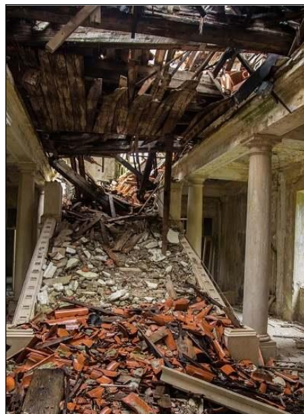
Schodiště na které se už propadla střeška
